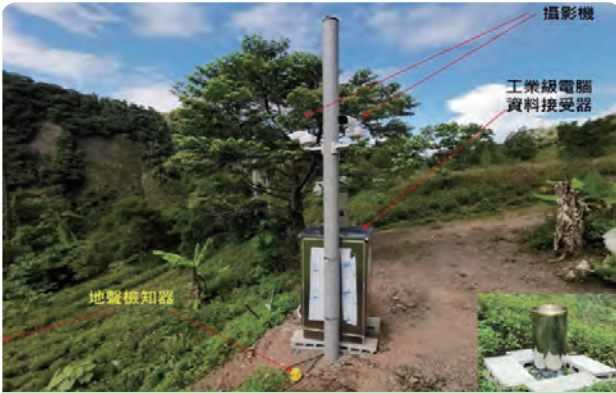
圖2-3-4 觀測站現地硬體設施情形
