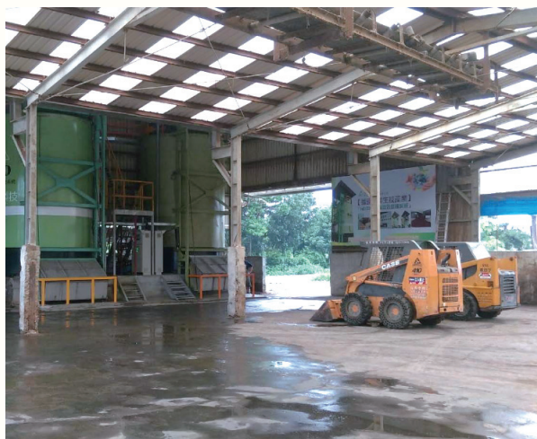
高雄蛋雞場設置禽畜糞高效處理系統解決雞糞不落地處理及惡臭。
