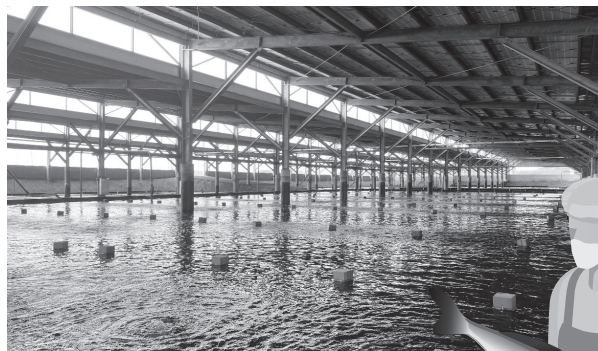
室內光電案場。
