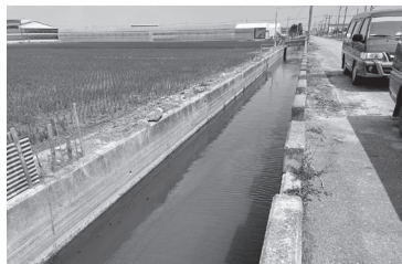
嘉南管理處崁後中排現地抽查。
