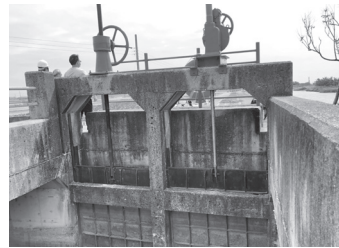
圖5. 雲林管理處——北港支線二區終點放水門。
