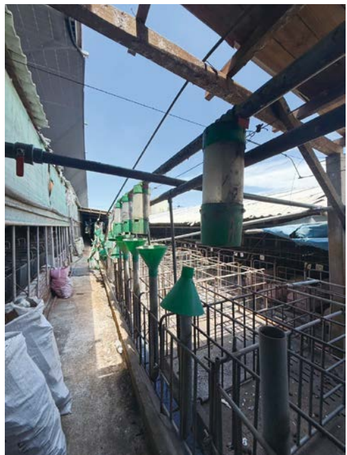
豬舍屋頂災損。
