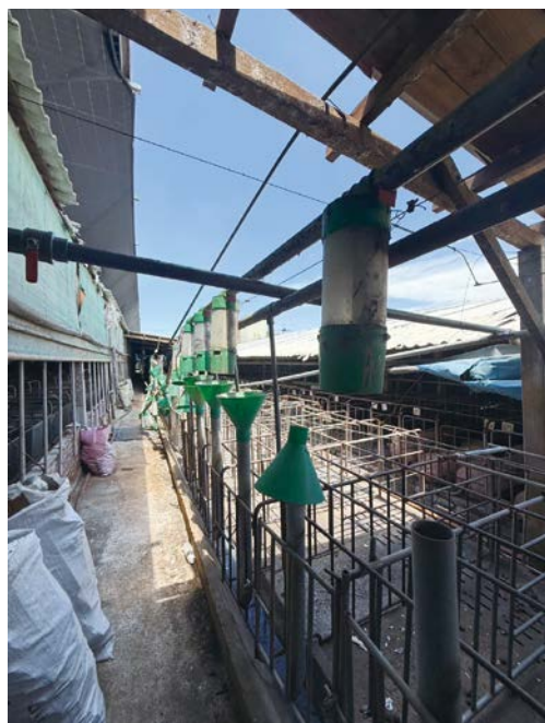
豬舍屋頂災損。
