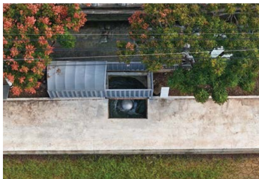
左圖：俯視臺中后里圳小水力發電機組。
