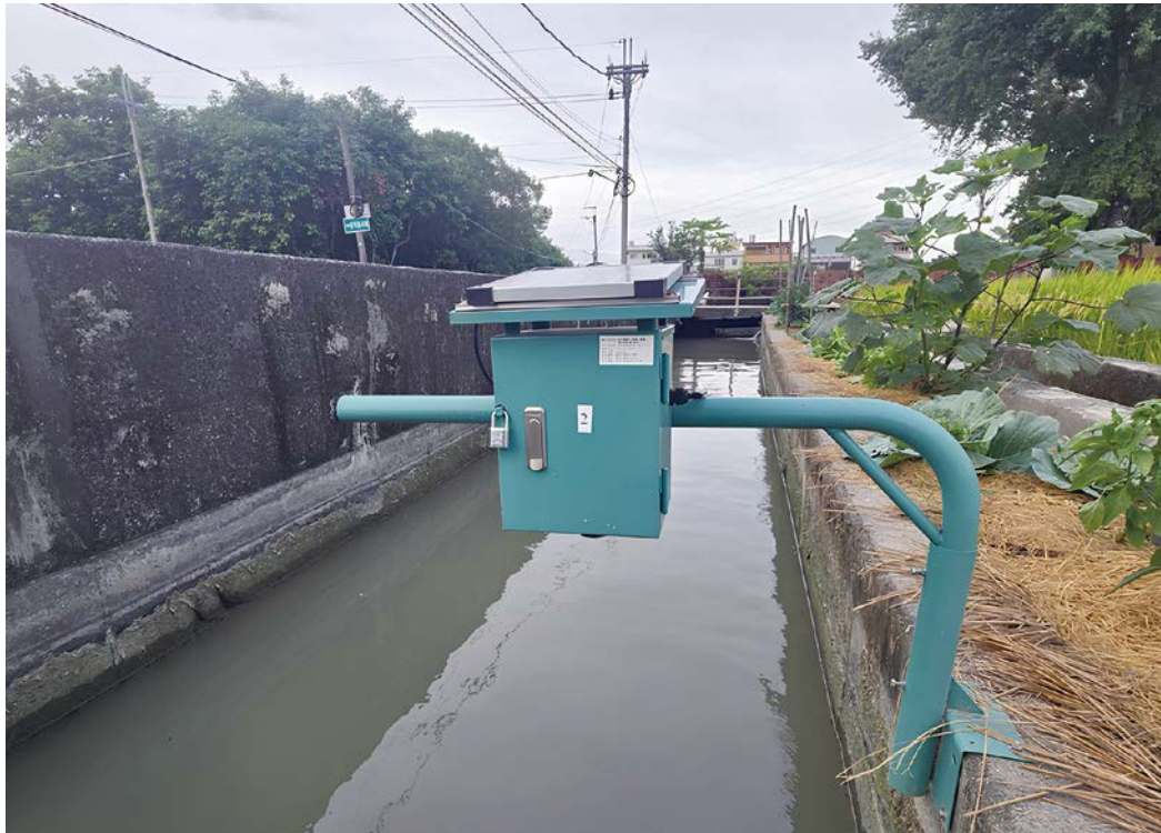
灌溉圳路水位計（南投阿罩霧第二幹線番仔圳支線）。
