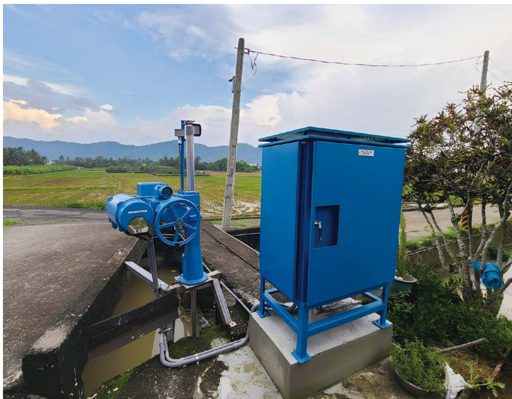
遠端遙控水閘門（高雄旗山圳二幹線九支線取水門）。
